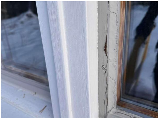
Bild 1: Utvändigt, Fönster, Färgsläpp på vissa fönster.
